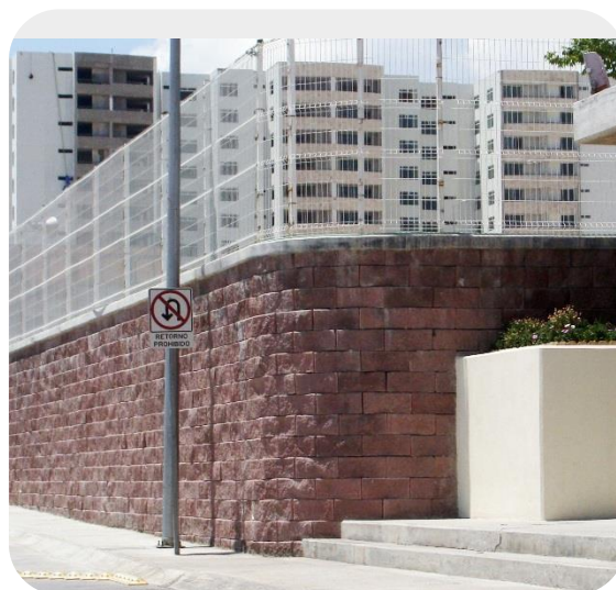
Ilustración 9 Muro de Contención con Sistema Mesa, Colegio Internacional Terranova, San Luis Potosí
